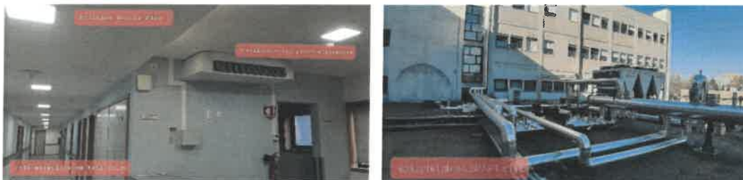
Foto 4: Rede Hidráulica e Aeráulica Medicina Homens Foto 5: Infraestrutura chiller trane e Rede Hidráulica
